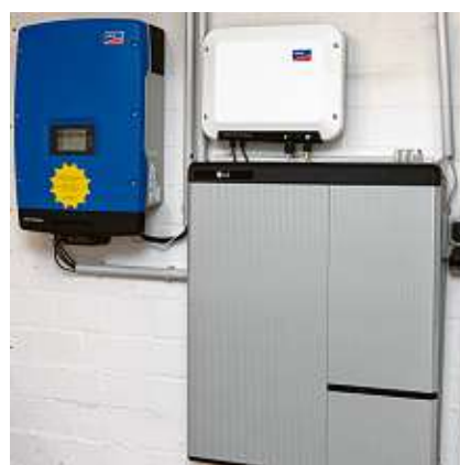
Die Schaltzentrale der Photovoltaikanlage im Hauskeller
